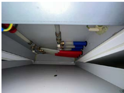
Stoppekraner plassert på bad
