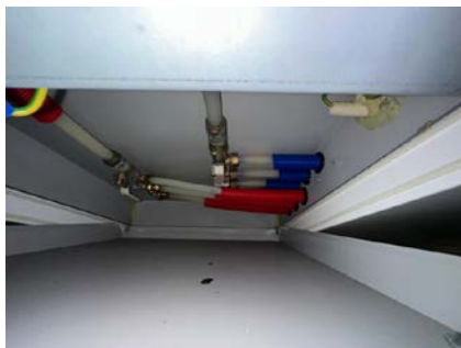
Stoppekranner plassert på bad
