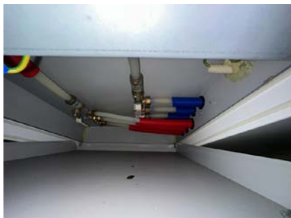
Stoppekraner plassert på bad
