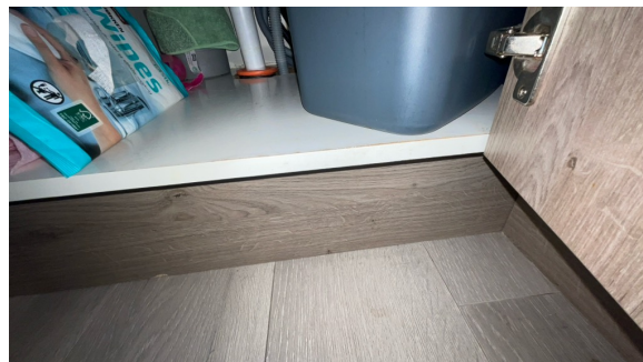
Fuktskjolder/svelling i bunnplate i benkeskap.
