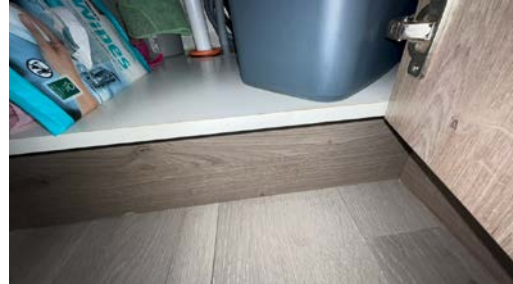
Fuktskjolder/svelling i bunnplate i benkeskap.
