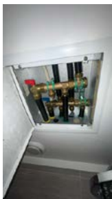
Stoppekran er plassert i inspeksjonsluke i bad.
