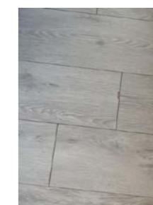
Enkelte sår/skader i endeskjøter.
