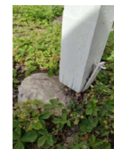
Søyle går helt i kanten av betongfundament.
