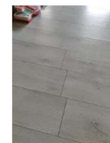
Laminatgulv er ikke lagt etter leggeanvisning.
