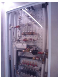
Felles fordelerskap med rør i rør systemet.
