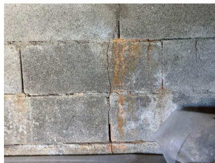
Riss i grunnmuren.
