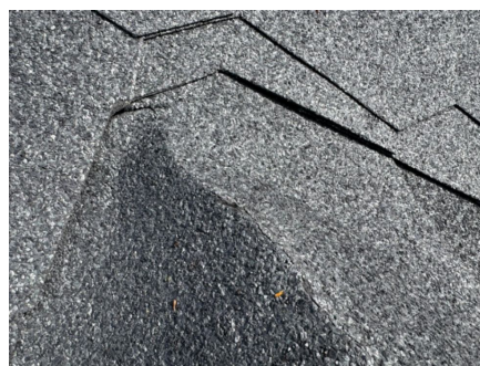
Sprekker i tekkingen.
