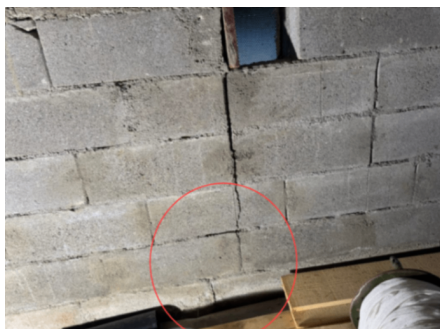
Riss i grunnmuren.
