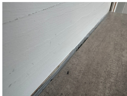
Svikt i fugemassen mellom benkeplaten og veggen.
