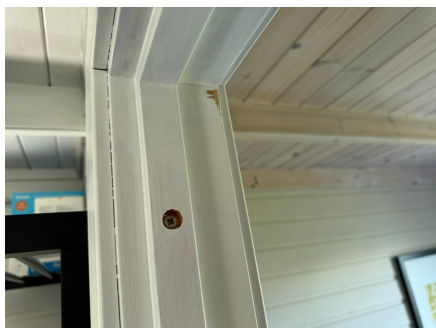
Eksempel på dør som tar i karm.
