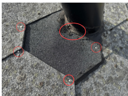
Spikret åpent og svikt i fugemassen.
