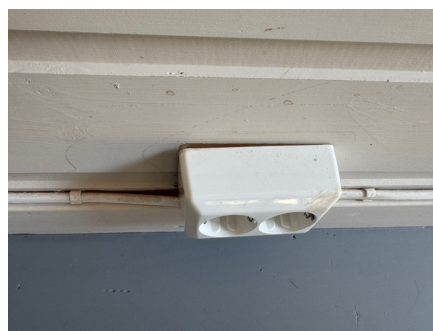
Løs stikkontakt på veggen.
