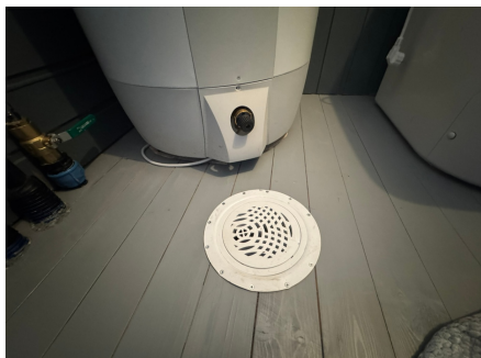
Sluk ved varmtvannstanken.
