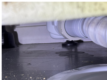
Tegn til drypplekkasje fra dusjkabinettet.
