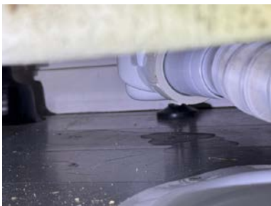
Tegn til drypplekkasje fra dusjkabinettet.
