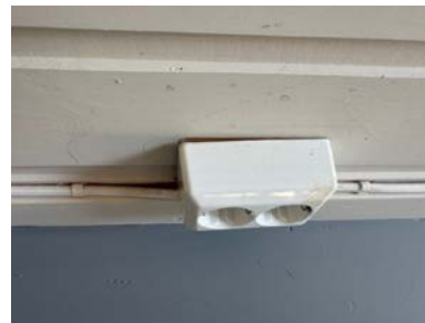
Løs stikkontakt på veggen.
