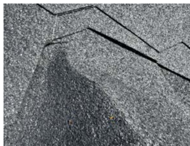
Sprekker i tekkingen.
