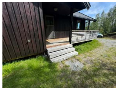
Det er ikke montert rekkverk på trappen.
