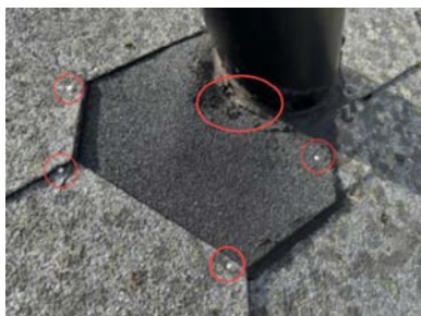
Spikret åpent og svikt i fugemassen.
