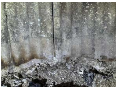
Sprekke i ildfast stein i ovnen.
