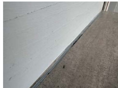
Svikt i fugemassen mellom benkeplaten og veggen.
