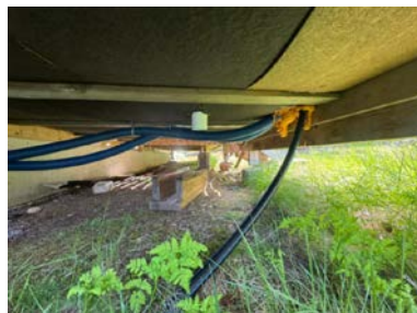
Fall mot grunnmuren.
