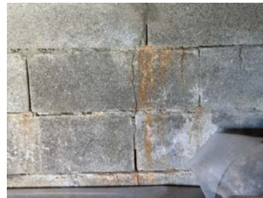
Riss i grunnmuren.
