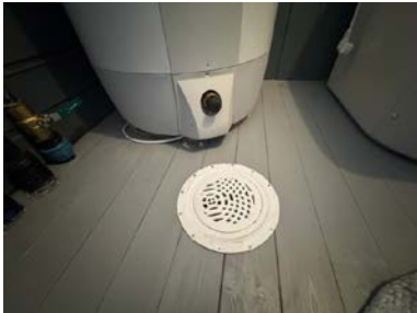
Sluk ved varmtvannstanken.
