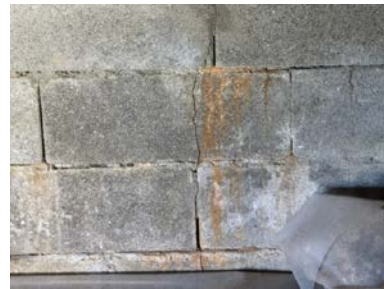
Riss i grunnmuren.
