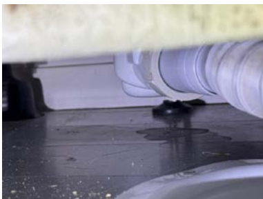
Tegn til drypplekkasje fra dusjkabinettet.
