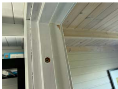
Eksempel på dør som tar i karm.
