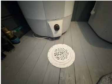
Sluk ved varmtvannstanken.
