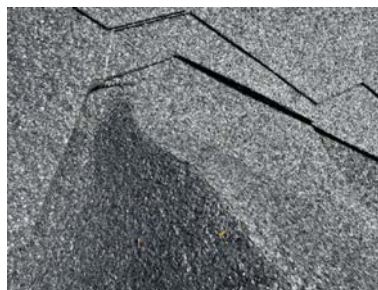
Sprekker i tekkingen.
