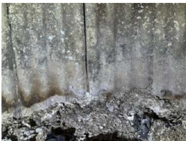
Sprekke i ildfast stein i ovnen.
