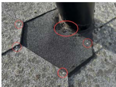
Spikret åpent og svikt i fugemassen.
