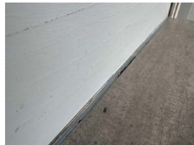
Svikt i fugemassen mellom benkeplaten og veggen.
