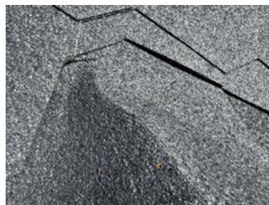
Sprekker i tekkingen.
