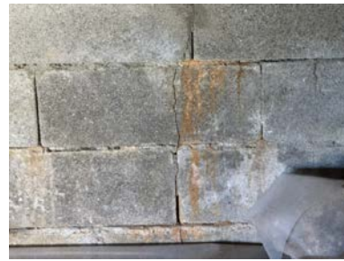
Riss i grunnmuren.
