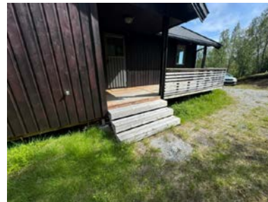
Det er ikke montert rekkverk på trappen.
