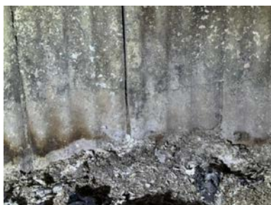
Sprekke i ildfast stein i ovnen.
