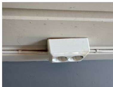
Løs stikkontakt på veggen.
