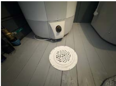
Sluk ved varmtvannstanken.
