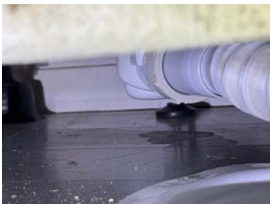
Tegn til drypplekkasje fra dusjkabinettet.
