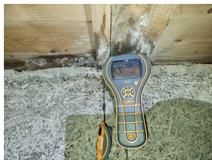
Forhøyede fuktmålinger i bjelkelag.
