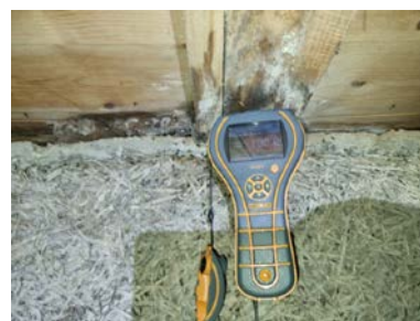
Forhøyede fuktmålinger i bjelkelag.
