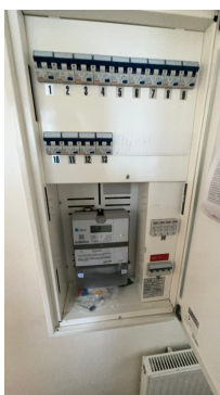
Sikringsskap lokalisert i felles trappegang entre.
