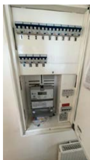
Sikringsskap lokalisert i felles trappegang entre.
