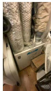
Balansert ventilasjonssystem lokalisert i bod i u. etasje.
