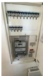
Sikringsskap lokalisert i felles trappegang entre.
