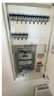
Sikringsskap lokalisert i felles trappegang entre.
