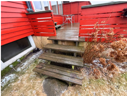
Mangler rekkverk i trapp
