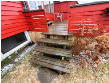
Mangler rekkverk i trapp
