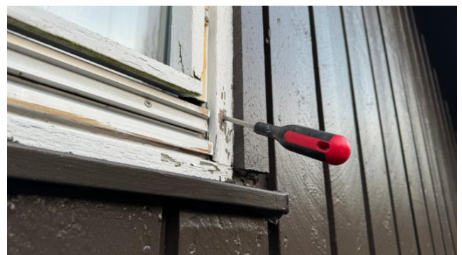
Stedvis råteskade i vinduer.
