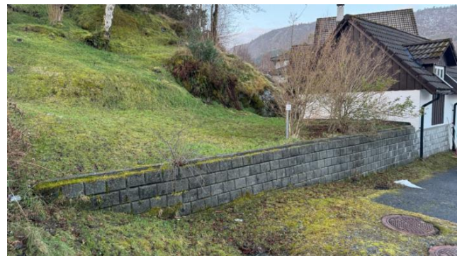
Bilde viser forstøtningsmur uten rekkverk/sikring
