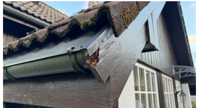
Bilde viser råteskade i vindski bord.
