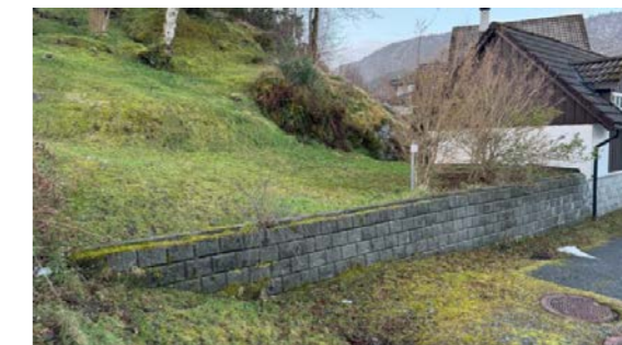
Bilde viser forstøtningsmur uten rekkverk/sikring
