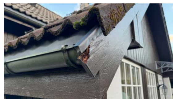
Bilde viser råteskade i vindski bord.
