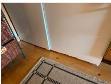
Rust i bunn av skap
