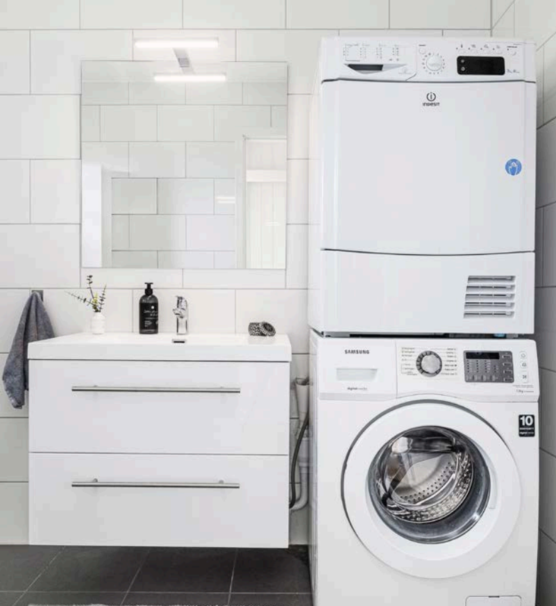
Det er opplegg for vaskemaskin og tørketrommel.
