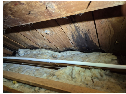
Ingen luftespalte i nedre del.
