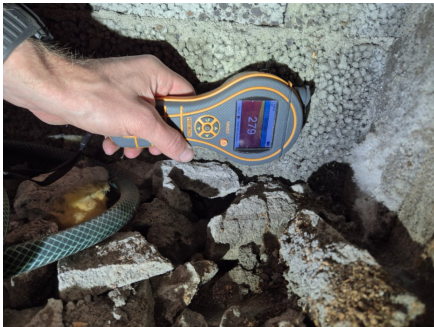
Saltutslag i krypkjeller.
