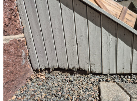
Råte i overbygg til kjellertrapp.
