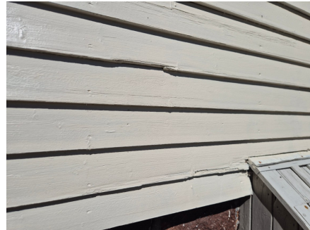
Råte i kledningsbord.
