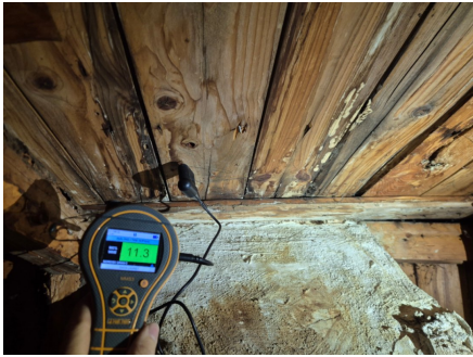
Eldre fukt skjolder rundt pipe, ikke målt noe unormalt med fukt.
