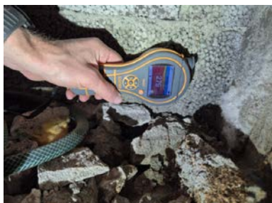
Saltutslag i krypkjeller.
