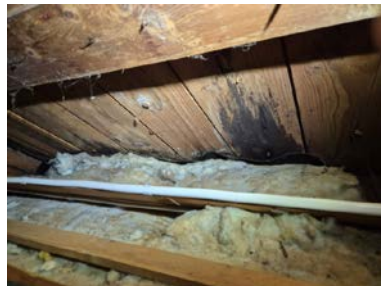
Ingen luftespalte i nedre del.
