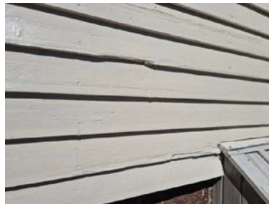
Råte i kledningsbord.
