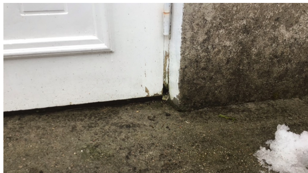
Kjellerdør med skader i underkant
