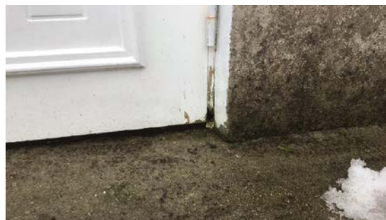
Kjellerdør med skader i underkant
