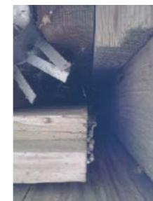
Mangler musesperre i ytterhjørner.
