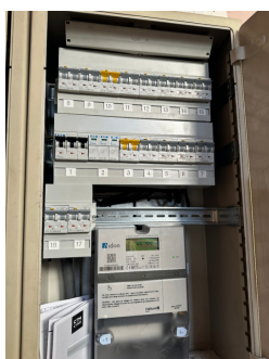
Sikringsskap med automatsikringer.
