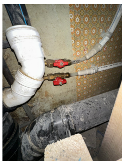
Stoppekraner med eldre tilførsel
