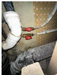
Stoppekraner med eldre tilførsel
