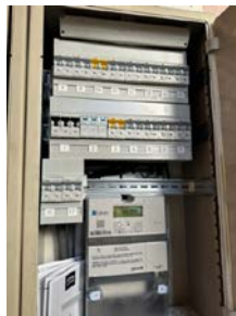
Sikringsskap med automatsikringer.
