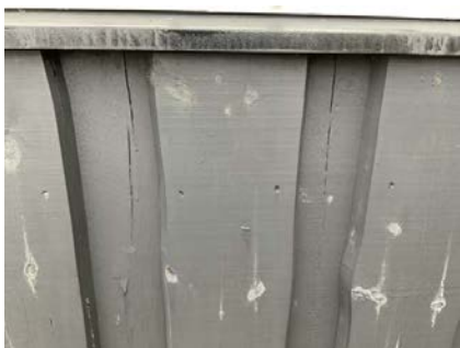
Sprekk i kledning.
