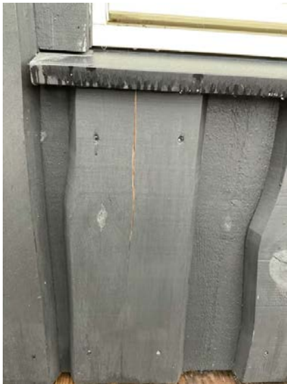
Sprekk i kledning.
