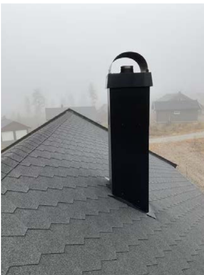
Pipe over tak.
