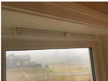
Ventiler i vindu.
