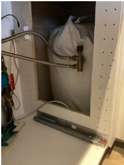
Bereder plassert under benk på kjøkken.
