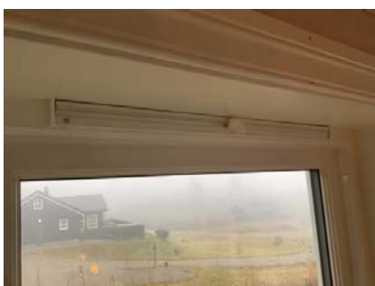
Ventiler i vindu.
