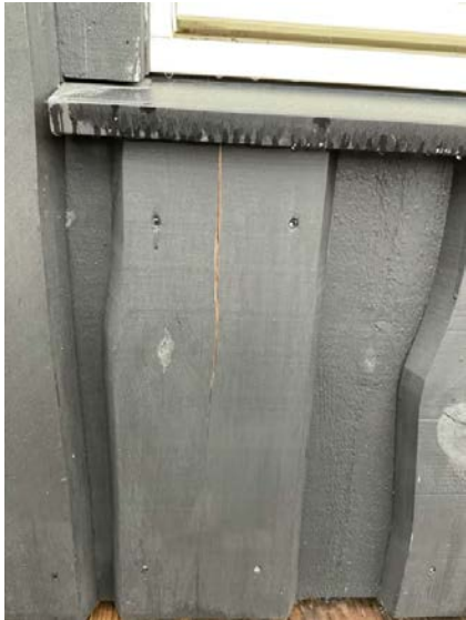
Sprekk i kledning.
