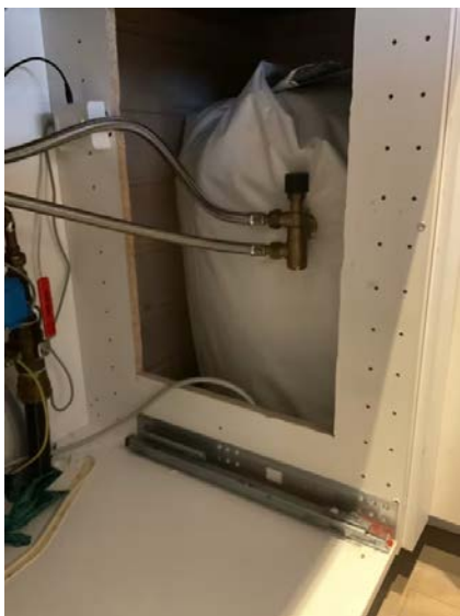
Bereder plassert under benk på kjøkken.
