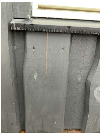
Sprekk i kledning.
