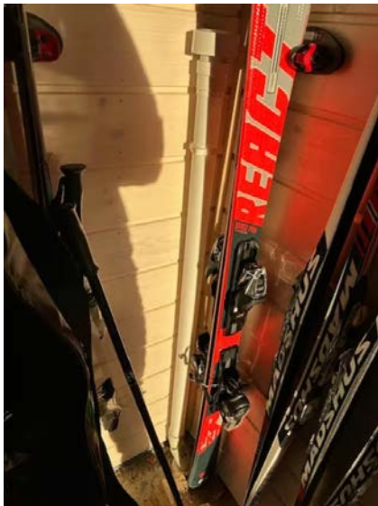
Lufting av kloakk.
