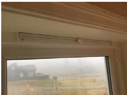
Ventiler i vindu.
