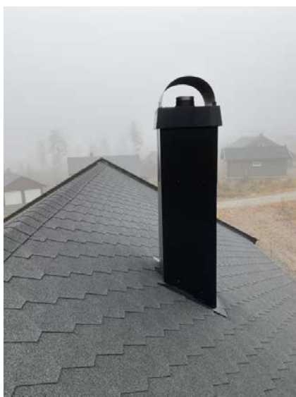
Pipe over tak.
