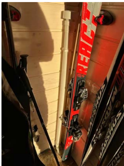
Lufting av kloakk.
