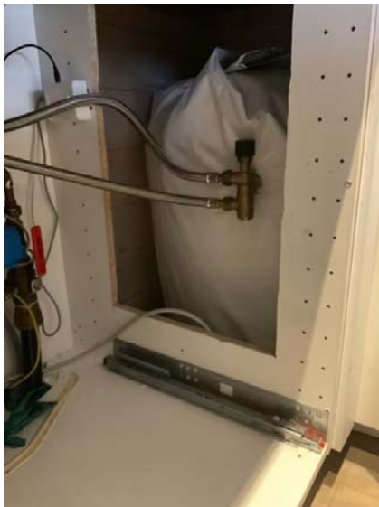
Bereder plassert under benk på kjøkken.
