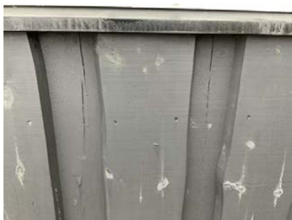
Sprekk i kledning.
