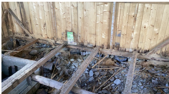
Hull i vegger etter råte.
