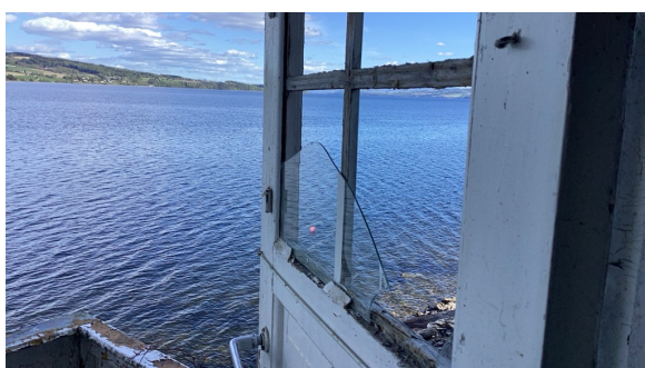
Knust vindu på terrassedør.
