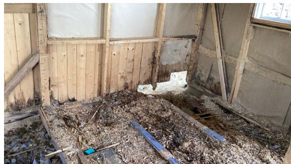
Hull i vegger etter råte.
