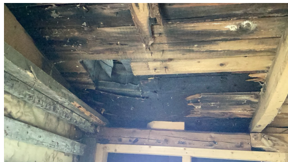
Store råteskader i undertak.
