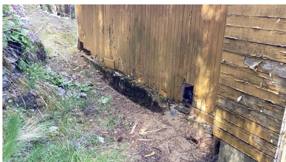
Store råteskader registrert.
