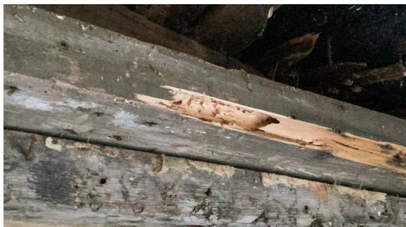
Spor etter treskadeinsekter, ukjent omfang. Ved stikktakning med syl kom det ut boremel.
