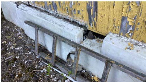
Store sprekker i mur.
