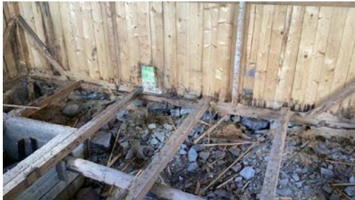
Hull i vegger etter råte.
