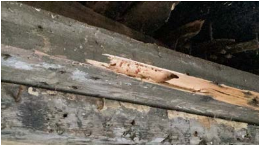
Spør etter treskadeinsekter, ukjent omfang. Ved stikktakning med syl kom det ut boremel.
