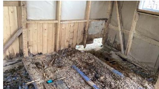
Hull i vegger etter råte.
