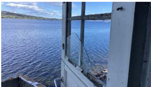
Knust vindu på terrassedør.
