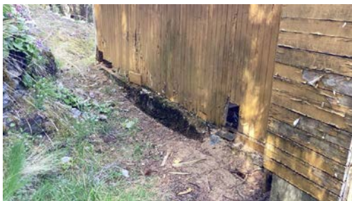
Store råteskader registrert.
