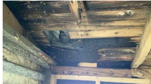
Store råteskader i undertak.
