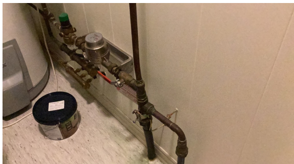
Vanninntak med måler og stoppekran på teknisk rom.
