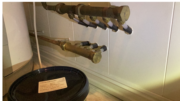
Samlestokker for vannrør på teknisk rom
