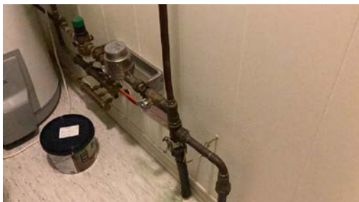
Vanninntak med måler og stoppekran på teknisk rom.
