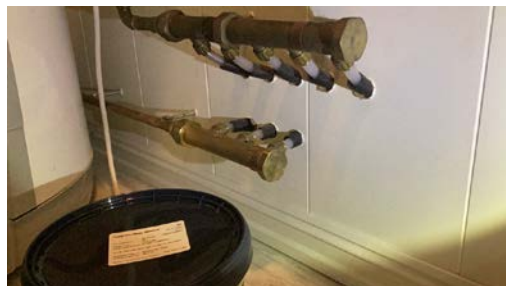
Samlestokker for vannrør på teknisk rom
