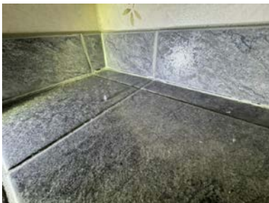
Eksempel på sprekker i overgangen mellom gulv og vegg.
