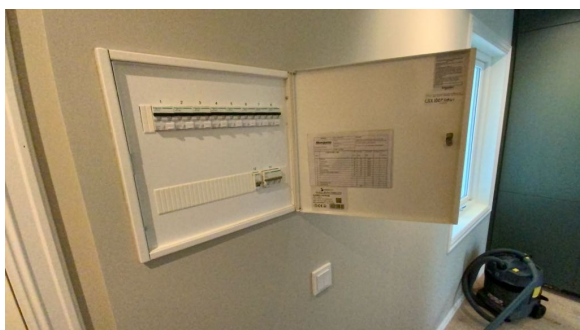
EI-skap med automatsikringer.
