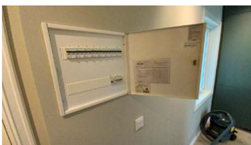
El-skap med automatsikringer.
