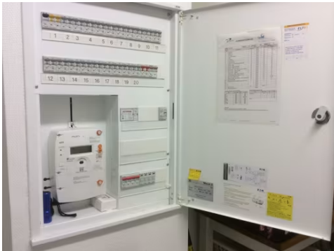
Sikringskap på vaskerom.
