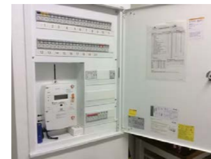
Sikringskap på vaskerom.
