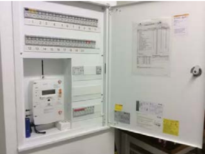
Sikringsskap på vaskerom.
