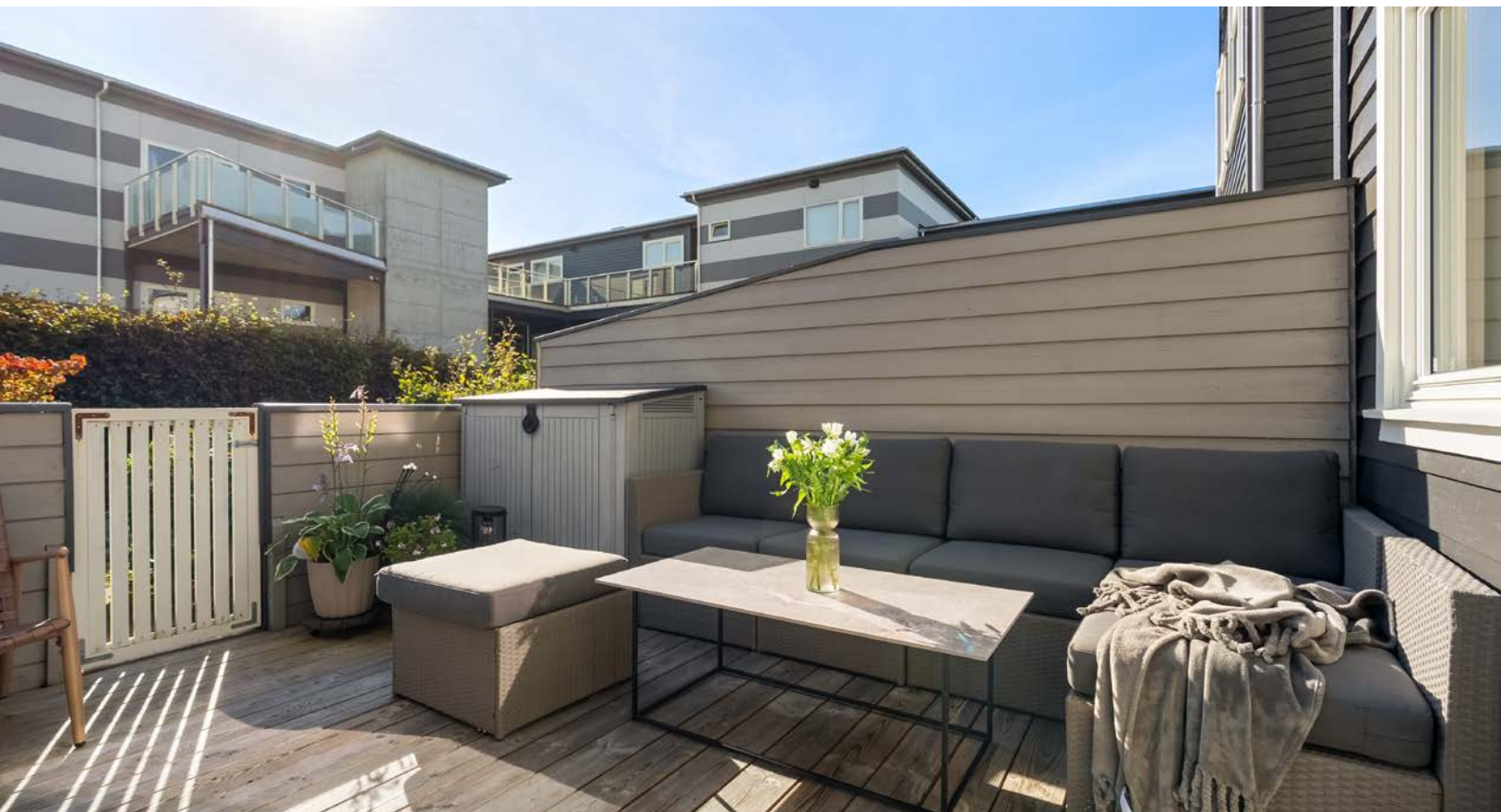
Liggende bordkledning på fasaden . Terrassebordene ble skiftet i 2023.
