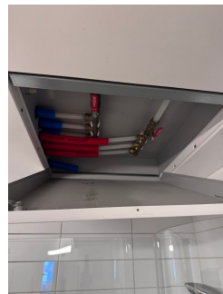
Skap med rørfordelere til bad og kjøkken.
