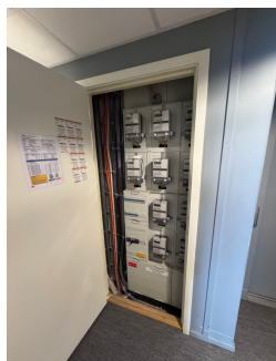
Hovedtavle med hovedsikring og strømmåler er plassert i oppgangen utenfor leilighetsdøren.
