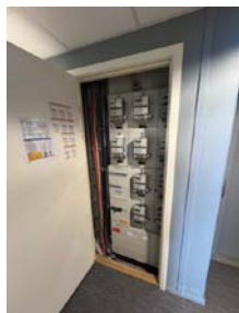
Hovedtavle med hovedsikring og strømmåler er plassert i oppgangen utenfor leilighetsdøren. Kursbetegnelse til hovedskap
