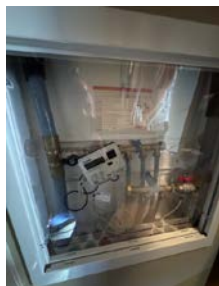
Vannfordelingskapp til radiatorene er montert i boden
