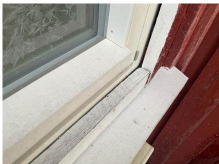
Utettheter mellom vindu og karm.
