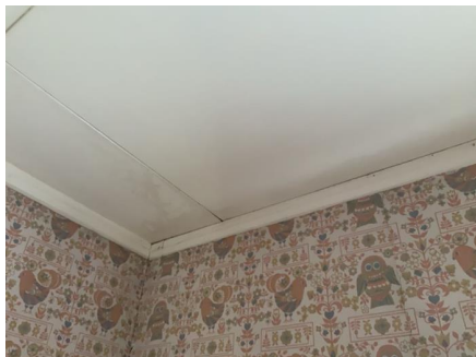
Fuktmerker i innvendig himling loftetasje.
