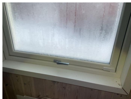
Ising på innvendig på vinduer da det er kaldere innvendig enn ute.
