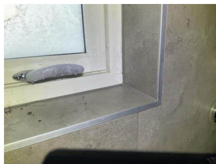
Ukjent tettesjikt/membran i vinduskarm i våtsonen.
