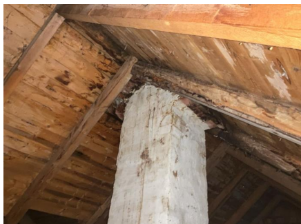
Lekkasjer er registrert rundt pipe, usikkert om det er nyere eller eldre fuktmerker, fuktmålinger er ikke foretatt.
