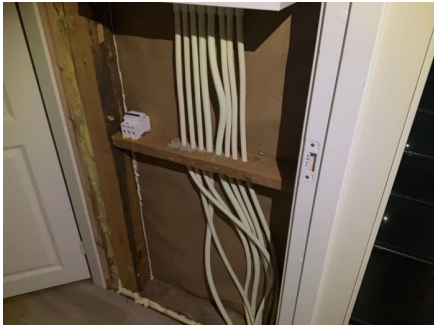
Vegg under sikringsskap.
