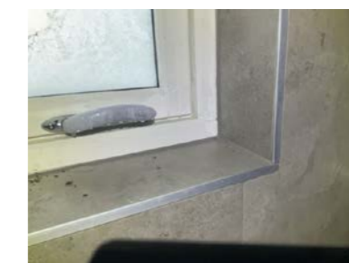
Ukjent tettesjikt/membran i vinduskarm i våtsonen.
