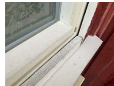
Utettheter mellom vindu og karm.
