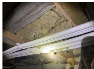
Det er åpninger i mot etasjeskille som gjør det mulig for skadedyr å ta seg inn i konstruksjonen.
