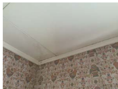
Fuktmerker i innvendig himling loftetasje.
