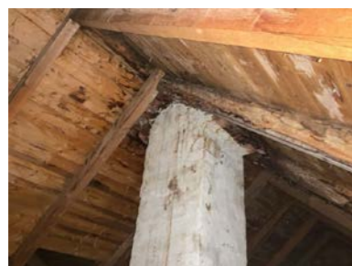
Lekkasjer er registrert rundt pipe, usikkert om det er nyere eller eldre fuktmerker, fuktmålinger er ikke foretatt.
