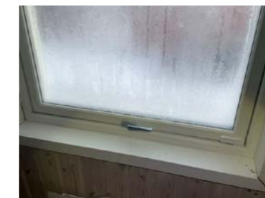
Ising på innvendig på vinduer da det er kaldere innvendig enn ute.
